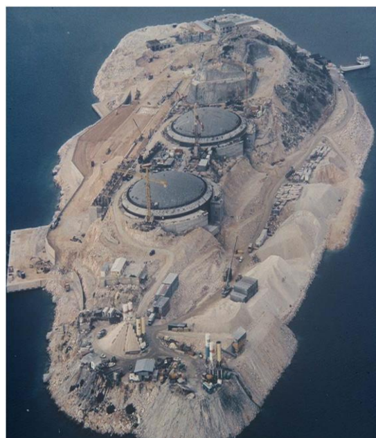
Picture 38. Revithoussa LNG Terminal.
